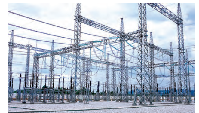
Bac Kan substation
